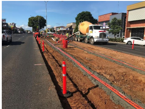
Electrical Conduit Protection
